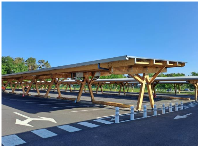
Ombrières de parking photovoltaïques à Haguenau (67)
